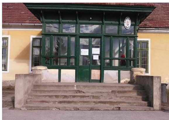
Legrégebbi épületrész (életveszélyessé nyilvánított)
