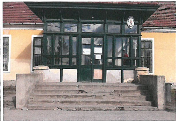
Legrégebbi épületrész (életveszélyessé nyilvánított)
